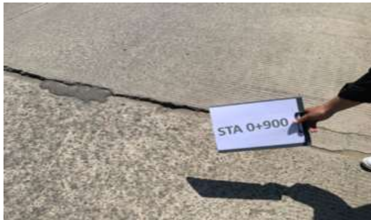
Gambar 4. Faulting di STA 0+900
