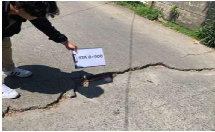
Gambar 3. Spalling Joint di STA 0+900
